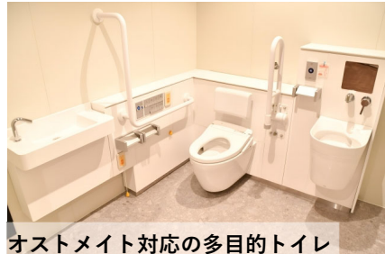
オストメイト対応の多目的トイレ
